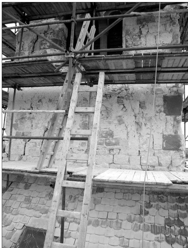
Obr. 10: Zábोří nad Labem, kostel sv. Prokopa, severní stěna věže po odkrytí omítek, v dolní části je patrný střechovitý tvar statických trhlín.
