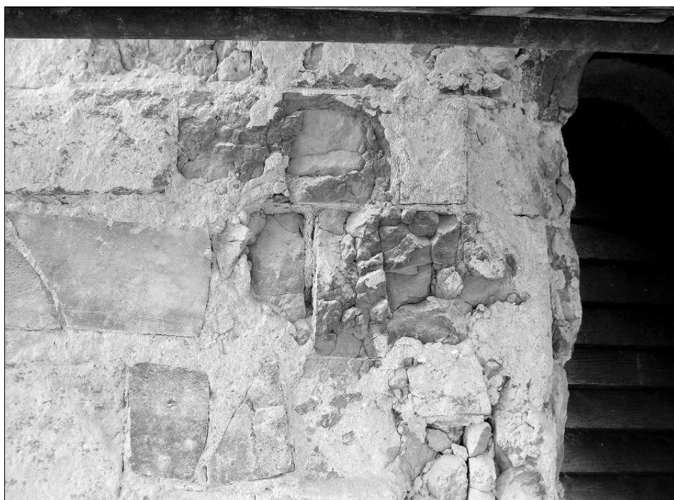
Obr. 3: Záboří nad Labem, kostel sv. Prokopa, poškozené kvádrové zdivo na východní straně věže (všechny snímky autor).
