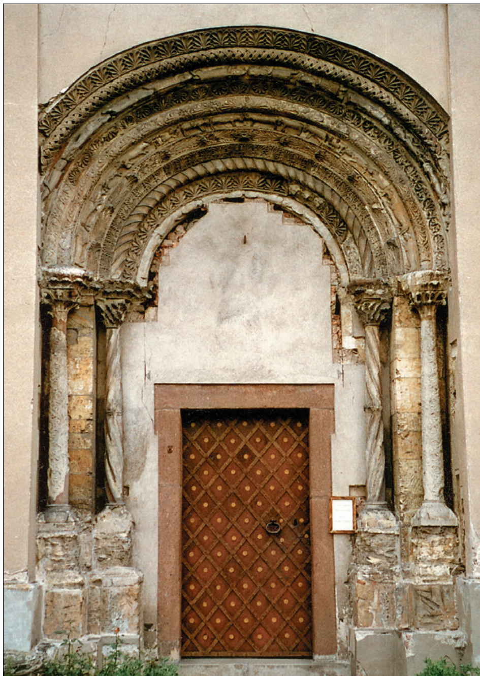
Obr. 2: Zábоři nad Labem, kostel sv. Prokopa. Stav románského portálu před započatím restaurování v roce 2002.
