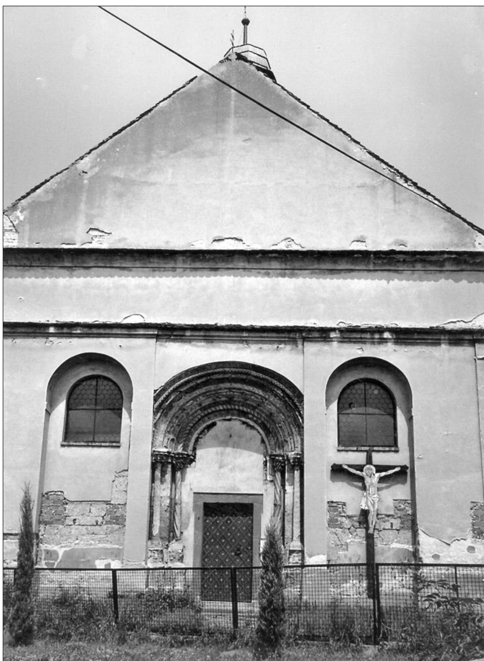
Obr. 1: Záborku nad Labem, kostel sv. Prokopa. Stav průčelí kostela před započatím restaurování portálu v roce 2002 (všechny snímky J. Bradna).
