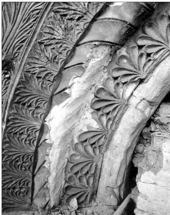
Obr. 7: Záboreň nad Labem, kostel sv. Prokopa. Levá strana archivoly, stav během snímání silné druhotné cementové vrstvy na provazci v roce 2003, jasně viditelné druhotné modelační doplňky. Vpravo již poodhalené figury spodního pasu.
