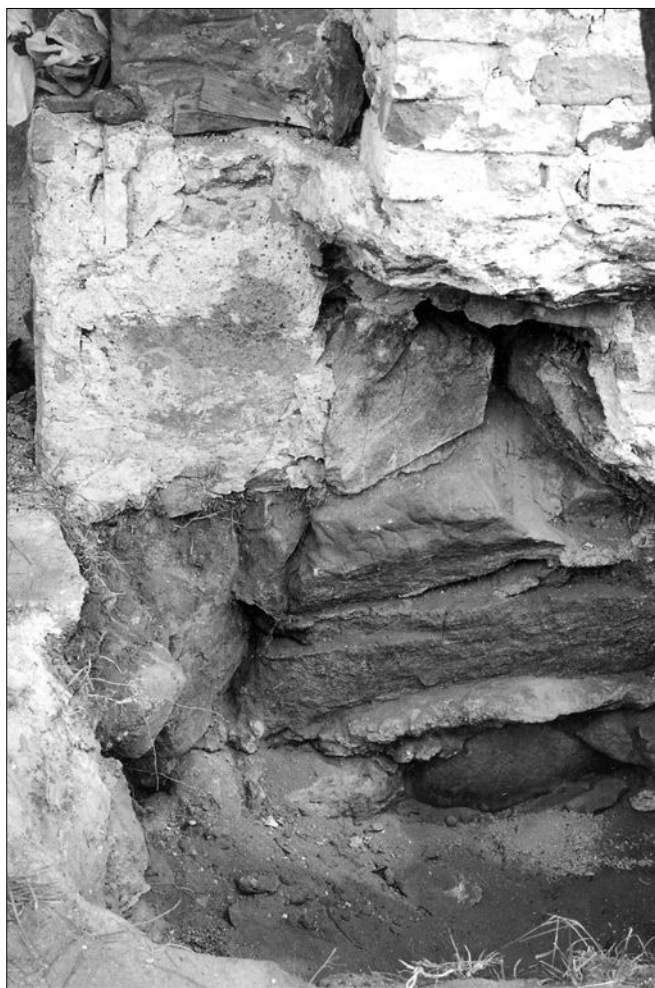
Obr. 24: Záboří nad Labem, kostel sv. Prokopa. Pravá strana portálu, kde nebyl pod předním pilířem téměř žádný základ. Hluboké dutiny v zadním zdivu základu (stav v roce 2003).
