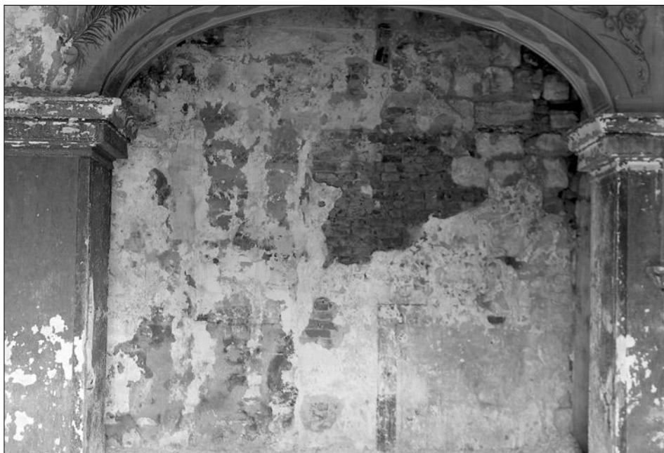
Obr. 17: Stvolínky, kostel Všech svatých, interiér, východní část severní zdi lodi (úroveň nad emporou) s patrným cihelným zdivem pod opadem omítky.
