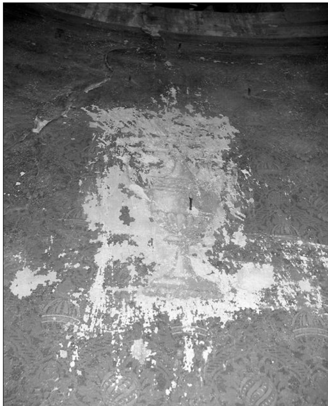
Obr. 31: Stvolínky, kostel Všechných svatých, interiér presbytáře, klasicistní motiv vázy, patrný pod destrukcí mladší dekorativní výmalby.
