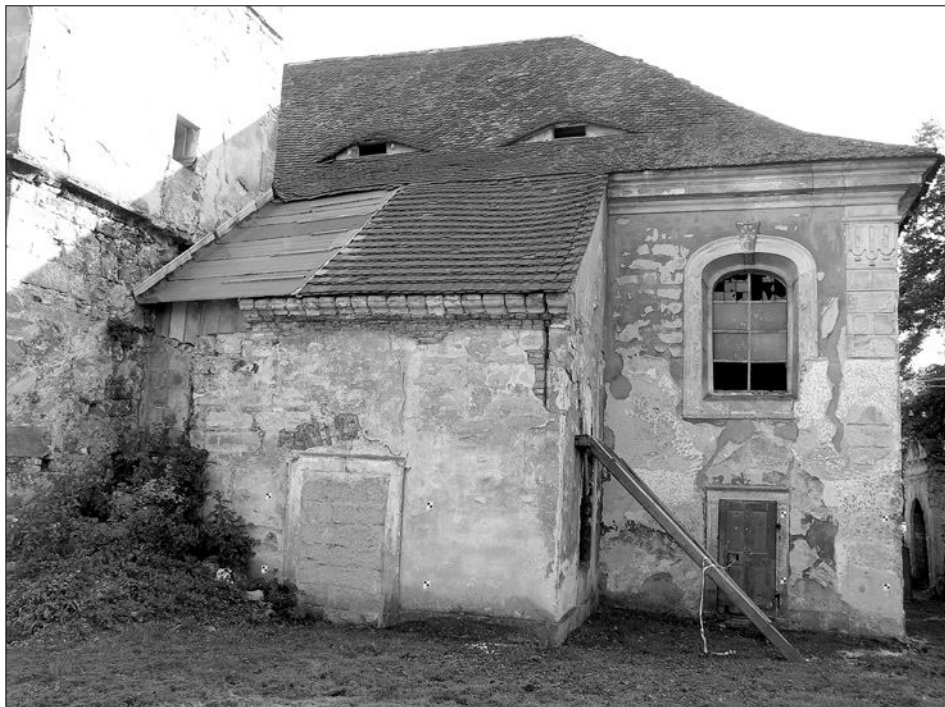
Obr. 29: Stvolínky, kostel Všech svatých, kaple sv. Anny, pohled od severu; vlevo patrné zhroutilé schodiště venkovního vstupu do 2. NP věže.
