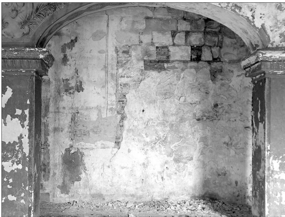
Obr. 23: Stvolínky, kostel Všechných svatých, interiér, severní zeď lodi se stopami zazděného otvoru v úrovni nad emporou.
