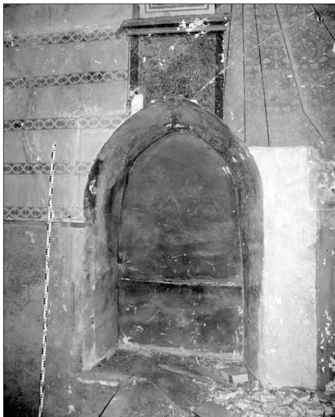
Obr. 14: Stvolínky, kostel Všech svatých, horní část špalety zazděného hrotitého okna v jižní ose západní zdi lodi, patrná z interiéru nad kruchťou.
