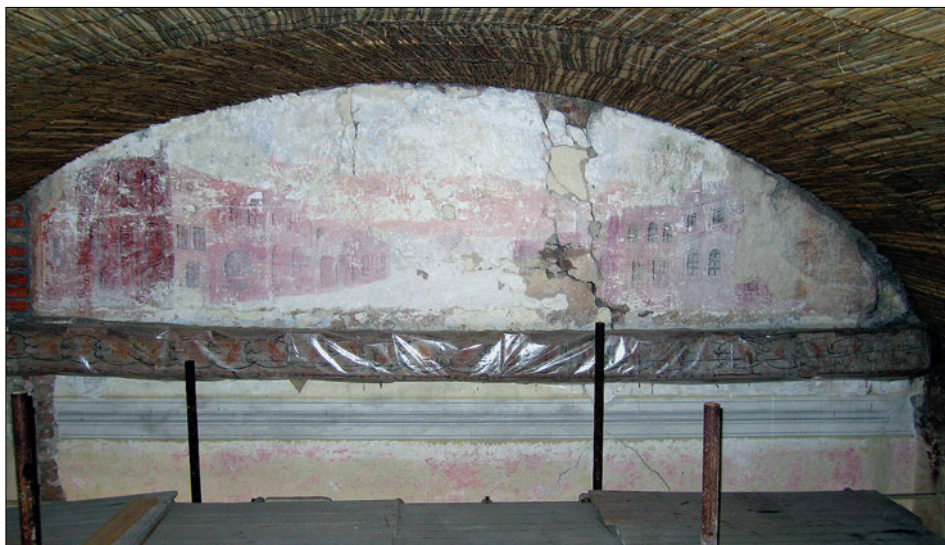
Obr. 13: Nové Dvory, malba „náměstí“ s kašnou na čele bedněné valené klenby nad kruchtou zámeckého kostela. Dole je jediný zachovaný trám barokního záklopového stropu s dlabky pro kladení prken záklopu. V horní části jsou patrné trhliny v místech zazděné spodní části původního vstupu do podkrovní.
