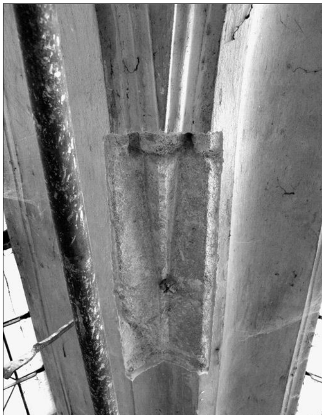
Obr. 10: Sedlec, kostel Nanebevzetí Panny Marie, sonda na stěně mezi okny kaple č. 5. Výběh žebra hruškového profilu gotické klenby byl i zde přerušen kapsou, do které byla vložena cihelná konstrukce barokní klenby. Barokně gotická klenba v partii výběhu navázala na původní konstrukci (foto A. Pospíšil, 2008).
