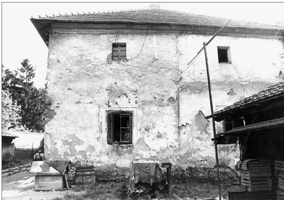
Obr. 8: Toušeň, čp. 31. Severní průčelí. Dobře je zřetelné svislé rozhraní předělující fasádu zhruba v ose. Mezi nárožím a levým oknem přízemí „prosívá“ rastr obdélníků sgrafitové výzdoby a v patře vlevo od pravého okna dekor snad v podobě tzv. psaníček (foto V. Hejda, 1974, snímek přiložený k plánové dokumentaci [viz popiska obr. 2]).
