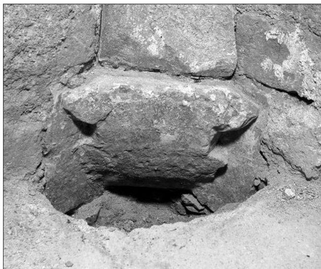
Obr. 25: Tzv. Juditina věž, Praha - Malá Strana; detail poškozené gotické konzoly a na ni nasedajícího zbytku žebra v jihozápadním koutě věže, nad patou klenby sklepa (foto J. Veselý, 2007).
