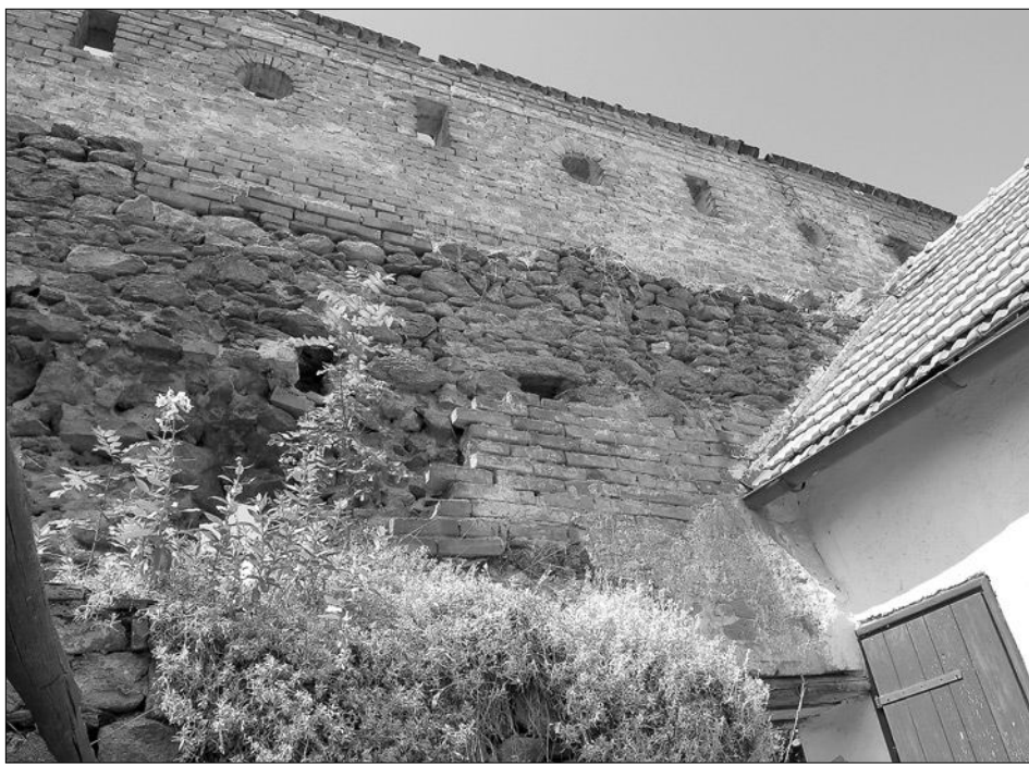
Obr. 16: Telč, úsek hlavní hradby za domem čp. 79, pohled na horní část z vnitřní strany. Dole gotická část s odbouraným ochozem a těžce poškozenou předprsní zídou, nahoře cihelná nástavba (foto V. Razím, 2001 a 2007).
