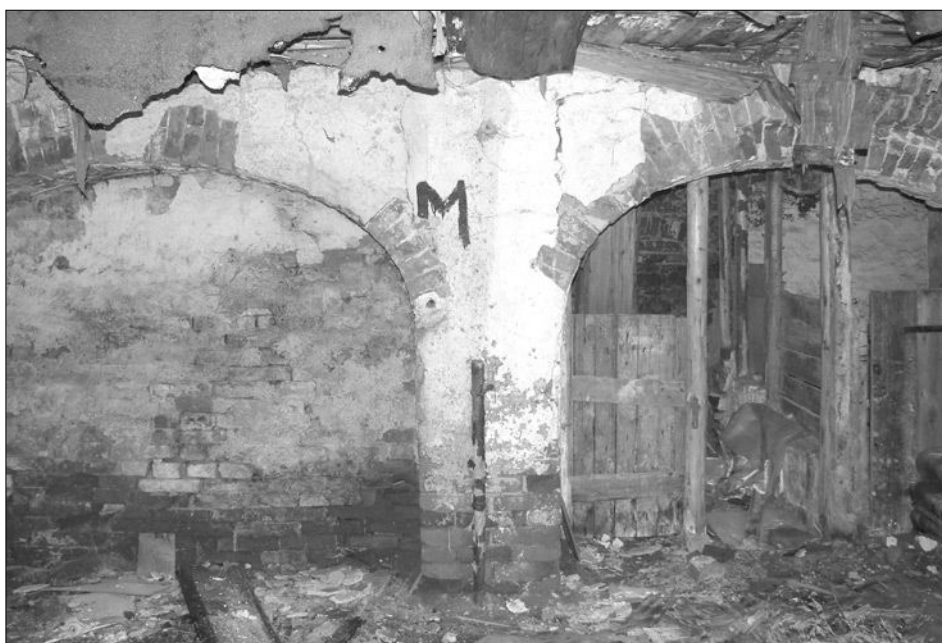
Obr. 16: Zlatá Koruna (okres Český Krumlov), bývalá flusárna, č. parc. 46. Jihovýchodní stěna kolny. Objekt je poznamenán dlouhodobou neúdržbou. Rozpad některých částí ovšem poskytuje možnost posoudit a dokumentovat konstrukční řešení i použité stavební materiály (foto J. Hansová, 2007).
