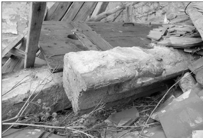
Obr. 4: Kaštice (okres Louny), zámek a dvůr čp. 1, stodola. Detail barokního architektonického článku, po zřícení části stavby uvolněného ze zdiva (foto F. Gabriel, 2007).
