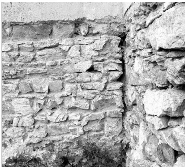
Obr. 12: Vícenice (okres Třebíč), kostel sv. Marka. Spára v koutě mezi severní stěnou lodi (vpravo) a sakristií, dokládající dodatečné připojení sakristie. Elaborát je ilustrován početnou sérií výtečně provedených snímků, které jsou lokalizovány značkami v připojeném plánu stavby. Bohužel však nejsou doplněny měřítkem, což mohlo být způsobeno situací na místě. Snímky ovšem velmi přehledně dosvědčují provedenou analýzu – spáry ve zdivu, rozdíly v provedení zdiva apod. (foto P. Dohnalová, 2007).
