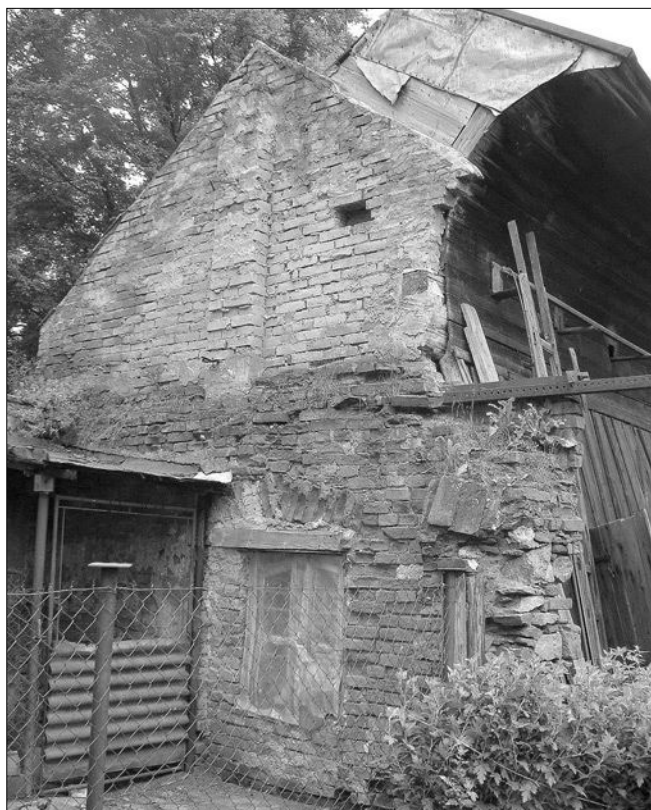
Obr. 3: Hostačov (okres Havlíčkův Brod), oranžerie v zámeckém areálu. Snímek dokumentuje stavební uspořádání památky, ale i její zbledovaný stav (foto L. Šabatová, 2007)
