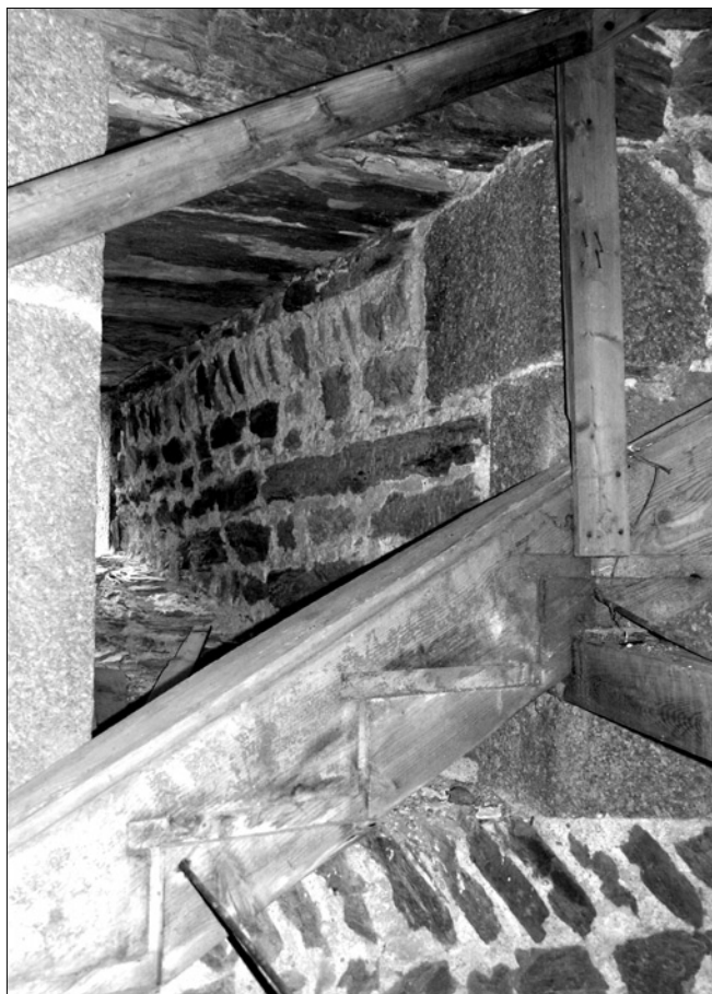
Obr. 23: Starý Hrozňatov (Kinsberg), hrad, pozdně románské okno ve vstupním podlaží, pohled z vnitřku. V popředí pozůstatky havarijního novodobého schodiště (foto J. Anderle, 2007).
