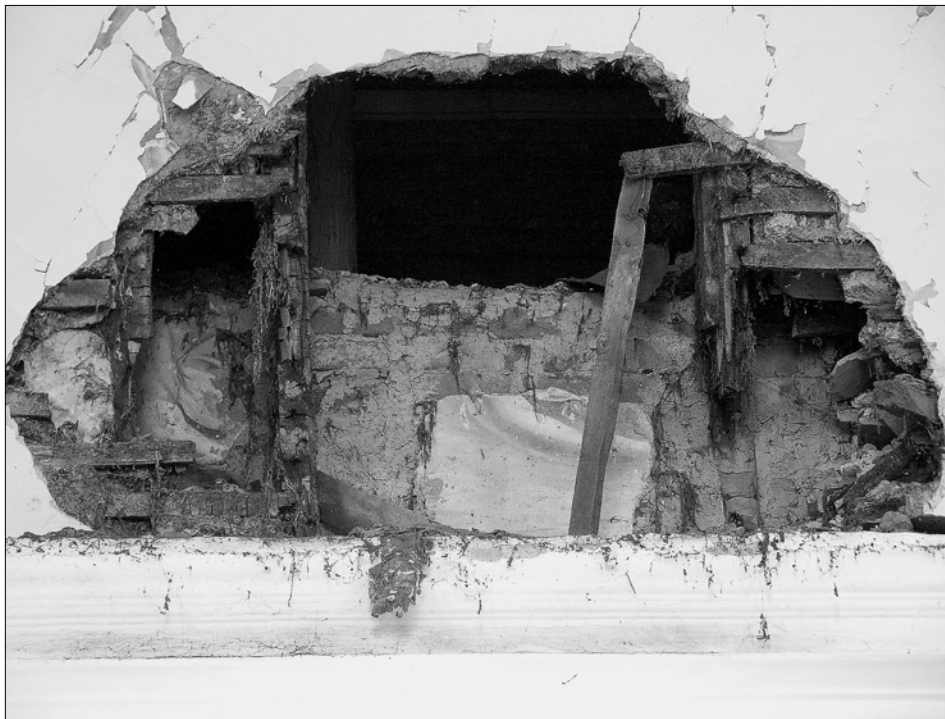
Obr. 42: Starý Hrozňatov (Kinsberg), zámecký kostel Nejsvětější Trojice. Prohnilá pata falešné klenby z roku 1767 na jižní straně lodi odhaluje zbytek starší zděné klenby opatřené nástěnnou malbou (foto J. Anderle, 2007).
