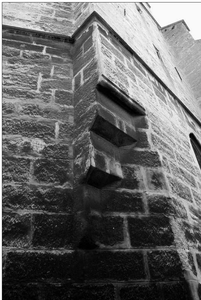
Obr. 14: Detail konstrukčního řešení severozápadního nároží severní věže kostela. Opěrák severozápadního nároží je situován šikmo. Nároží nedobíhá k zemi, nýbrž je vyneseno stupňovitými konzolami (foto J. Beránek, 2009).
