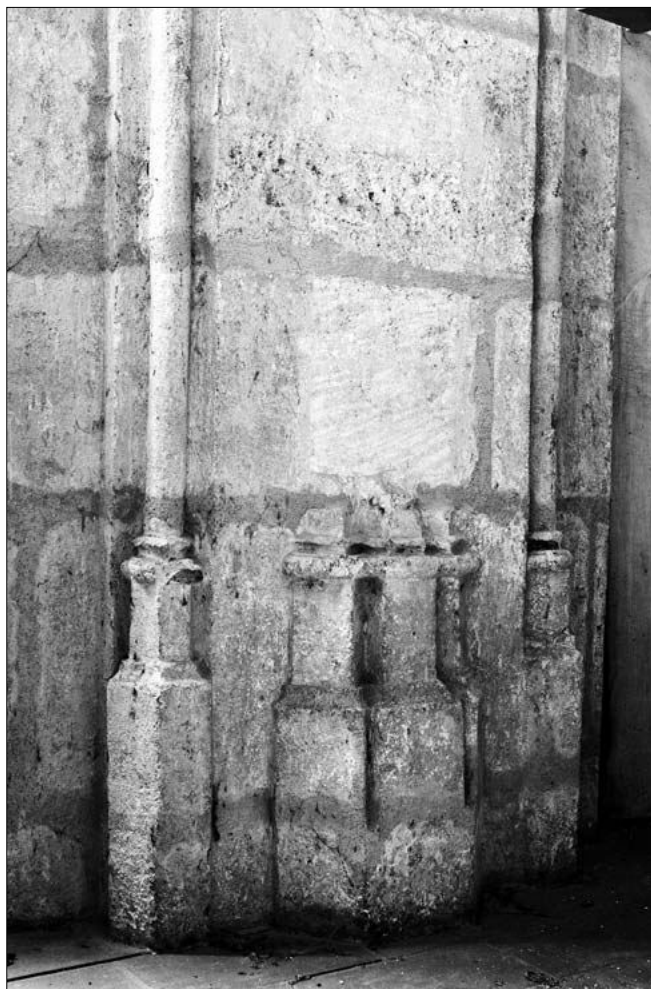
Obr. 22: Detail členění fragmentu soklu sdružené přípory, z níž vyrůstaly prvky diagonálních žeber a žebra oddělujícího dvě pole křížové žebrové klenby prostory nad sakristií. Krajní oddělené soklíky náležejí oblému prutu v ostění nerealizovaných oken (foto A. Mudra, 2009).
