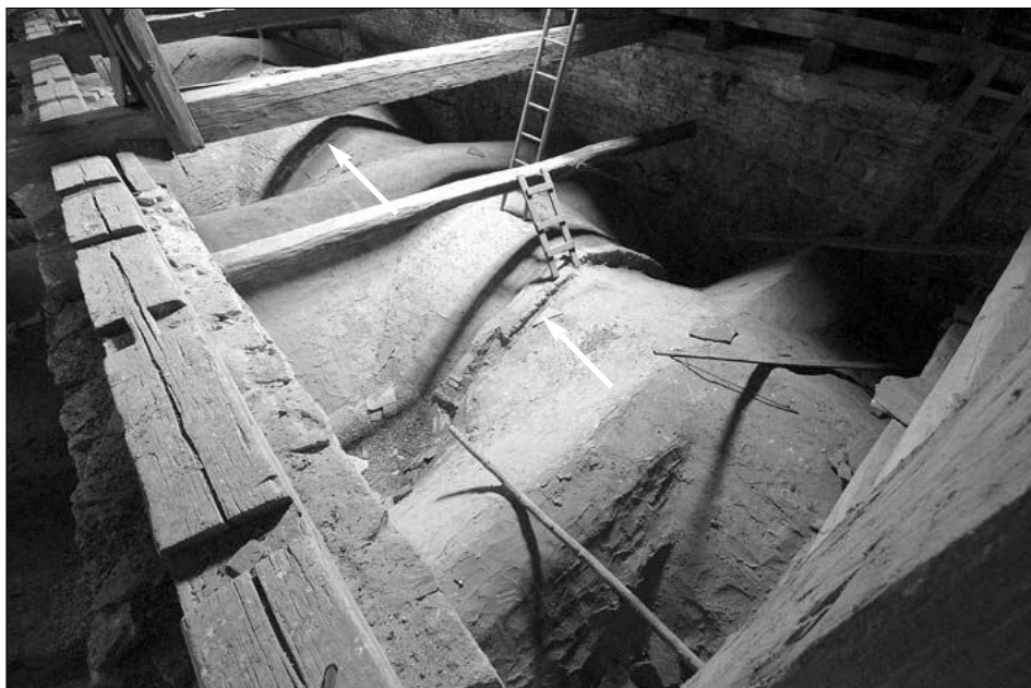
Obr. 53: Západní část kleneb jižní boční lodi. Pohled od severovýchodního nároží jižní věže. Vlevo na nadezdívce jižní mezilodní arkády dochována prahová vaznice pozdně středověkého krovu. Pozoruhodné je, že jednotlivá klenební pole v celém rozsahu jižní lodi oddělují cihelné rubové pasy, které jsou typické nikoliv pro středověké, nýbrž pro mladší barokní konstrukce (foto J. Beránek, 2009).
