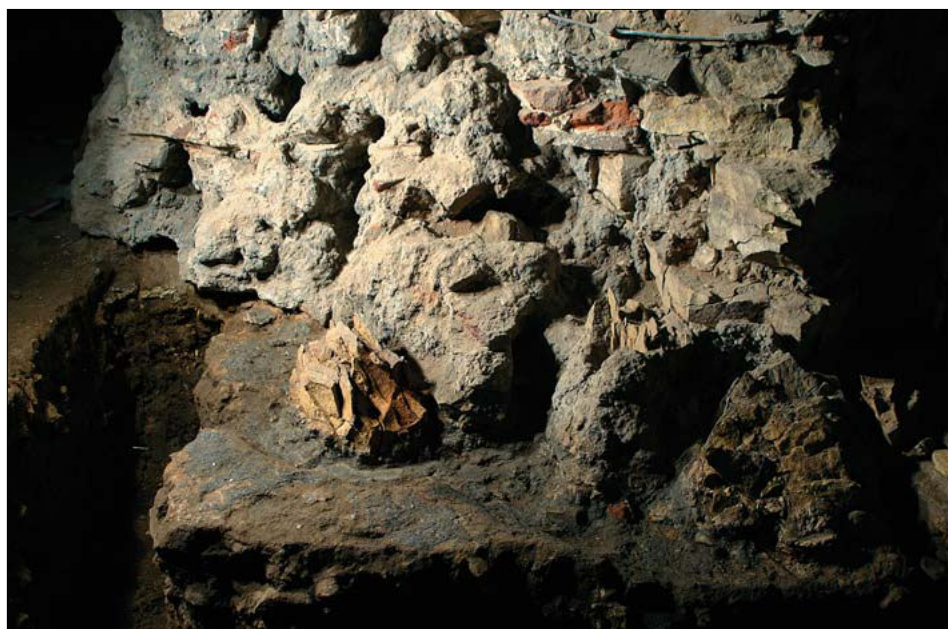
Obr. 11: Jediný fragment původní podlahy v centrálním prostoru, před čelem pilíře č. 4, zmenšený našimi výkopy pro kanalizaci. Okolo opukového balvanu vymodelována v podlaze mělká stružka. Vzadu na stěně pilíře otisk po olověné trubce. Pohled od severozápadu (foto M. Müller).
