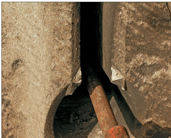
Obr. 7: Znojmo, věž za čp. 361. Detail motivu přetínání na hraně klíčové střílny hlavního průčelí (čerstvě poškozen při stavbě lešení) (foto autor, 2006).
