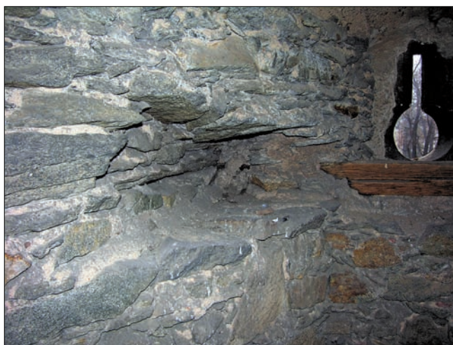
Obr. 14: Znojmo, věž za čp. 361. Detail špalety východní střílny 2. patra, s negativem hlavy zaniklého původního trámku (foto autor, 2009).
