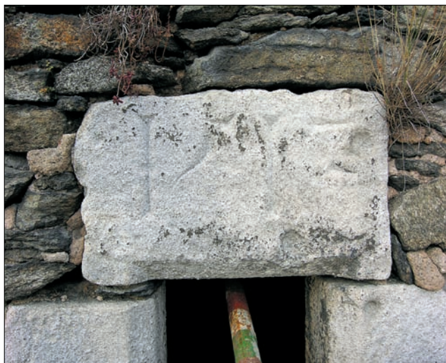
Obr. 8: Znojmo, věž za čp. 361. Nadpraží střílny 3. patra v hlavním průčelí, s původním datem 1513 (foto autor, 2006).
