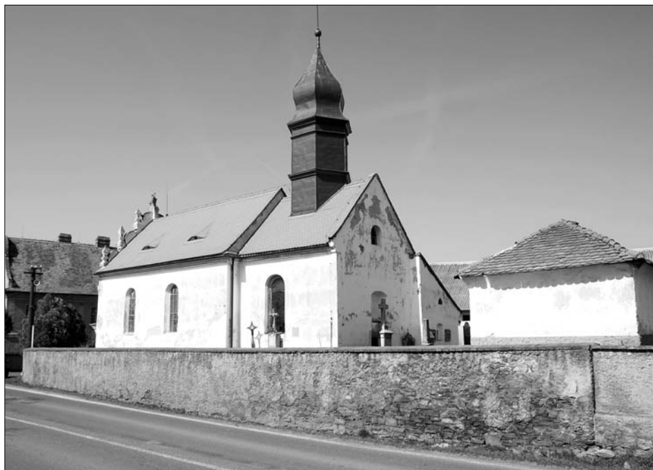
Obr. 15: Krchleby, okres Kutná Hora, pohled na kostel sv. Václava od jihovýchodu, stav před opravou (foto 2009).
