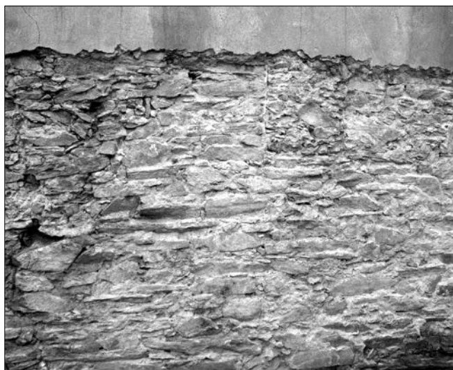
Obr. 10: Jindice, kostel sv. Václava, šikmé rozhraní středověkého zdiva lodi a barokní dostavby, vpravo nahoře zazděné středověké okénko, stav po sejmutí omítek během opravy.
