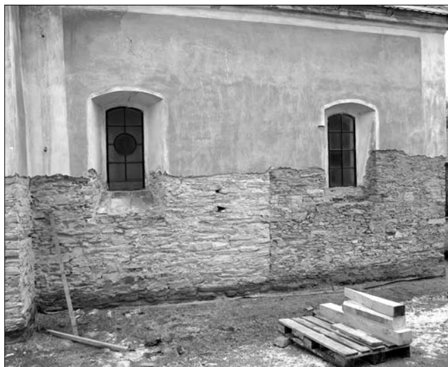
Obr. 9: Jindice, kostel sv. Václava, rozhraní středověkého zdiva presbytáře a pozdější dostavby sakristie, pohled od jihu, stav po sejmutí omítek během opravy.
