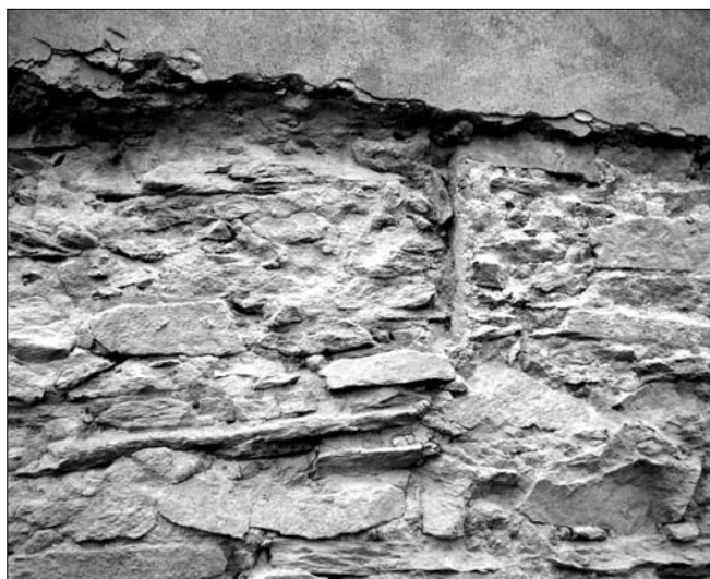
Obr. 11: Jindice, kostel sv. Václava, špaleta východního ze dvojice středověkých okének na jižní straně lodi, stav po sejmutí omítek během opravy.
