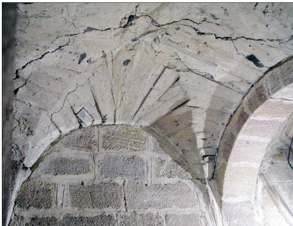
Obr. 18: Svojšín, kostel sv. Petra a Pavla. Otisky bednění klenby podvěží se zbytky prken (foto M. Hauserová).
