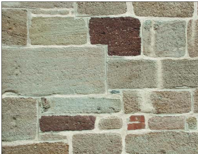
Obr. 16: Svojšín, kostel sv. Petra a Pavla. Detail vyrovnávání nestejně vysokých vrstev kvádrů pomocí pravoúhlého zazubení. Cihlou vyplněný otvor po lešení. Původní spárování zaniklo při novodobých úpravách líce věže (foto M. Falta).
