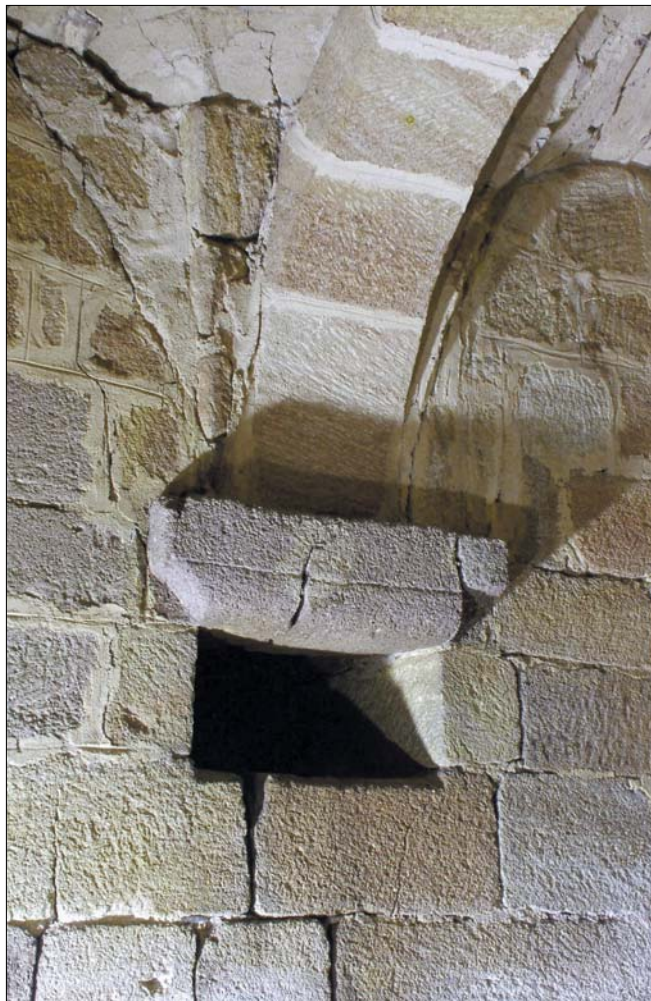
Obr. 17: Svojšín, kostel sv. Petra a Pavla. Dosednutí klenebního pasu v podvěží na nadokenní překlad, které logicky vedlo k jeho prolomení (foto M. Falta).
