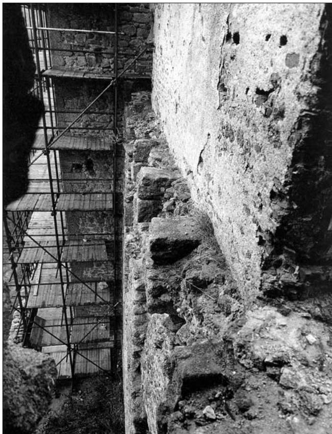
Obr. 38: Landštejn. Zbytky krakorců zaniklého ochozu paláce, detailní pohled z portálku severní věže (srov. obr. 36 a 37). Stav před rekonstrukcí, duben 1981, jako obr. 16.
