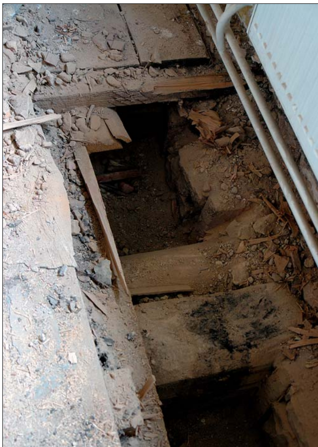
Obr. 36: Severní část přístavby k budově strojních dílen – pohled shora na detail konstrukce stropu nad přízemím s opálenými konci trámů.
