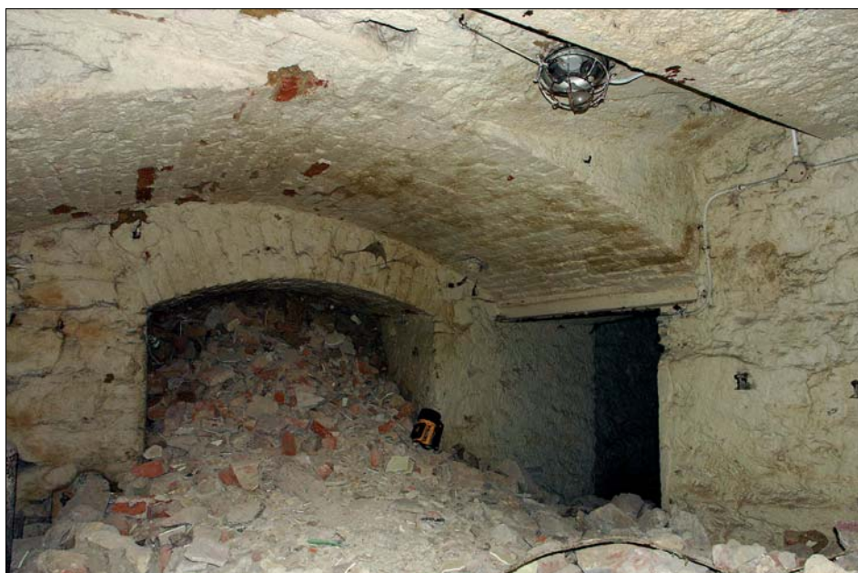
Obr. 37: Severní část přístavby k budově strojních dílen – zavalený sklepní prostor.
