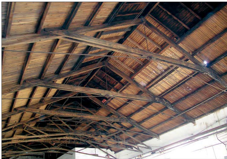
Obr. 66: Lokomotivní remíza – krov nad zbořenou jižní částí objektu.
