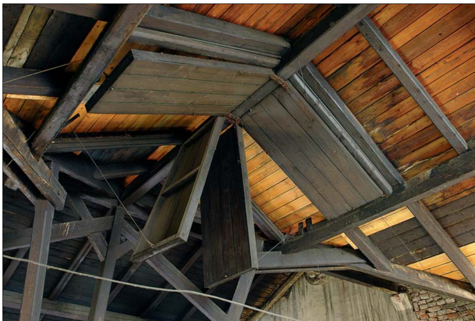
Obr. 60: Západní vestavba u lakovny – sklápěcí kryty pod někdejším světlíkem(?) ve styku obou částí krovu.
