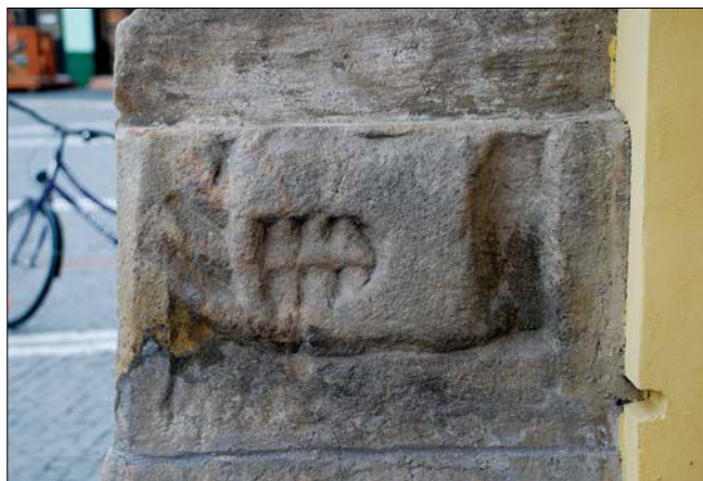
Obr. 28: Česká Lípa, dům čp. 2, portál z roku 1555. Jižní strana patky severního sloupu s poškozeným reliéfem kančí hlavy.
