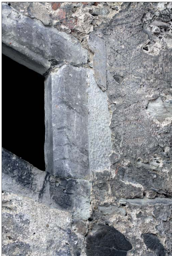
Obr. 10: Ústí nad Labem - Krásné Březno, kostel sv. Floriána, schodišťová věž při jižním průčelí, detail šikmého okenního otvoru schodiště s fragmentem hlazené okenní pasparty (foto M. Pavlíková, 2010).
