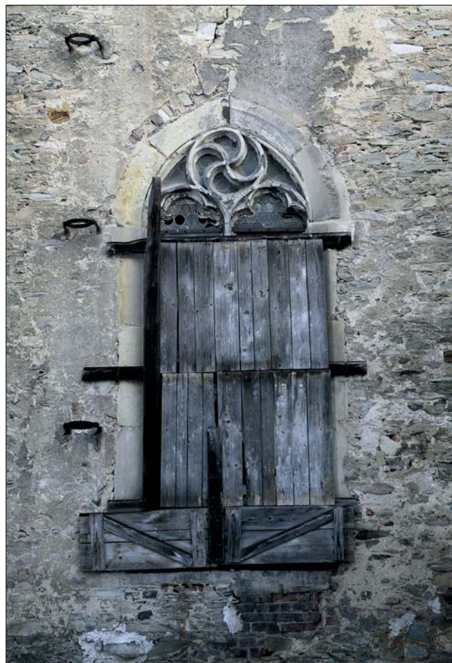
Obr. 14: Ústí nad Labem - Krásné Březno, kostel sv. Floriána, jižní průčelí lodi, pod parapetní částí okenního otvoru patrné druhotně zazděné prolomení otvoru pro proražení vstupu na jižní rameno empor. Vstup sloužil po záplavě v roce 1783, kdy přestala fungovat schodišťová věž při jižním průčelí. Vstup byl zrušen po odtěžení terénu před J průčelím po roce 1935 (foto M. Pavlíková, 2010).
