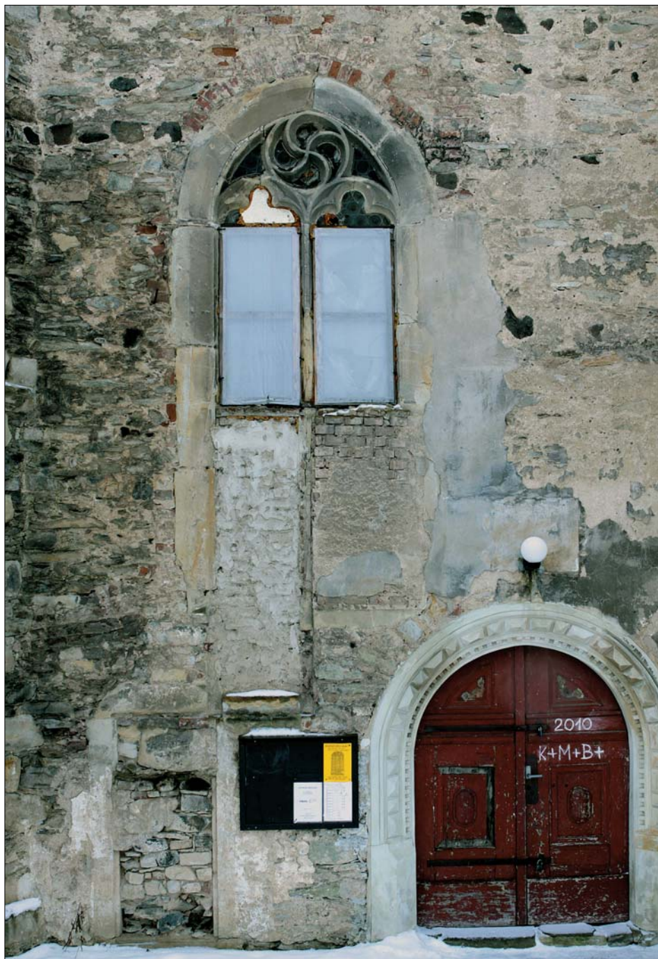
Obr. 4: Ústí nad Labem - Krásné Březno, kostel sv. Floriána, severní průčelí, vedle nejstaršího vstupu do kostela zazděný pravouhlý vstup na severní rameno empor, zřejmě z období let 1714–1751. Pravouhlý vstup, který zanikl pravděpodobně s povodní v roce 1783, nahradil vstup na severní emporu přes okenní otvor lodi. Ten zanikl po odtěžení terénu z okolí kostela v 90. letech 20. století (foto M. Pavlíková, 2010).
