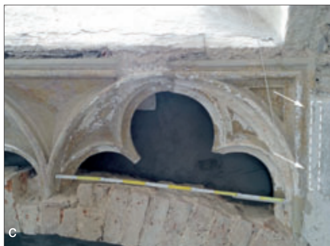
Obr. 14: Benátky nad Jizerou, kostel Narození Panny Marie: a – kružba sedíle; b – detail levé části. Šipkami označena odsekaná část kvádrů s maltovou vysprávkou. Podle návaznosti kružby a profilace levého ostění, zachovaného pouze u druhého kvádrů odshora v malém úseku nad cihelným pasem, lze předpokládat, že levý a střední díl kružby pocházejí z původního výklenku; c – detail pravé poloviny kružby. Rohový díl neodpovídá střednímu a levému dílu. Mohl tak být druhotně použit i z jiné části stavby. Šipkami označena maltová vysprávka v kvádrů ostění.
