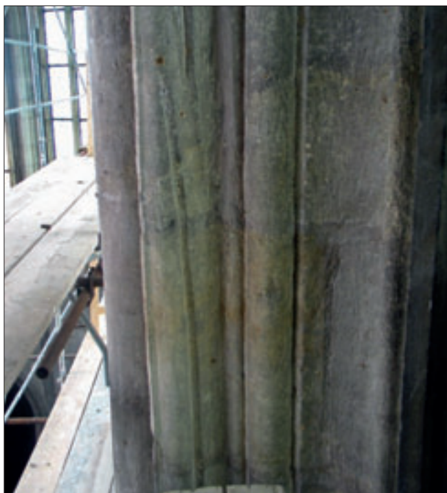
Obr. 18: Kolín, chrám sv. Bartoloměje, detail přípory v jižní okenní stěně vysokého chóru, se zřetelnými stopami odsekaného klenebního výběhu, cca 160 cm níže než je výběh stávající.
