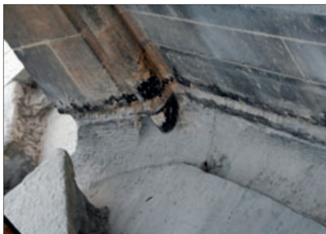
Obr. 23: Kolín, chrám sv. Bartoloměje, spodní část stěny vysokého chóru v úrovni ochozu. Při rekonstrukci krytby ochozu v létě 2010 bylo zjištěno, že pata vnější stěny chóru oble přechází do roviny krytby původní, níže položené; zřejmě v tomto místě vytvářela zároveň žlab, sloužící jako dešťový svod.
