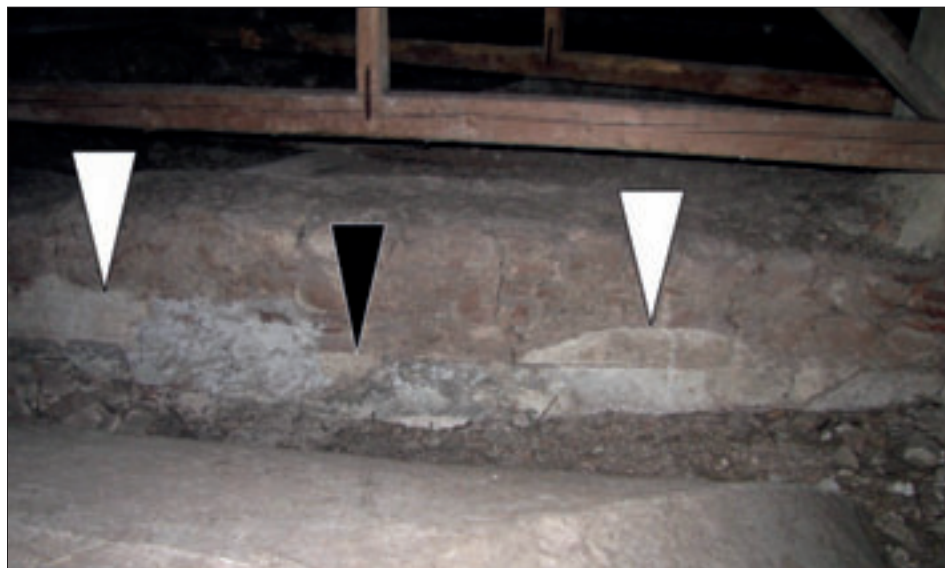
Obr. 30: Hrad Buchlov, půda, detail západního líce zdi, dělicí v 1. patře místností č. 24 a 25; bílé šipky ukazují na pozůstatky interiérových omítek dvojice klenebních čel, černá šipka míří na vodorovnou hranu, kterou je ukončena plocha omítek mladších, souvisejících s rovnými stropem nad místností č. 25; pohled od západu.
