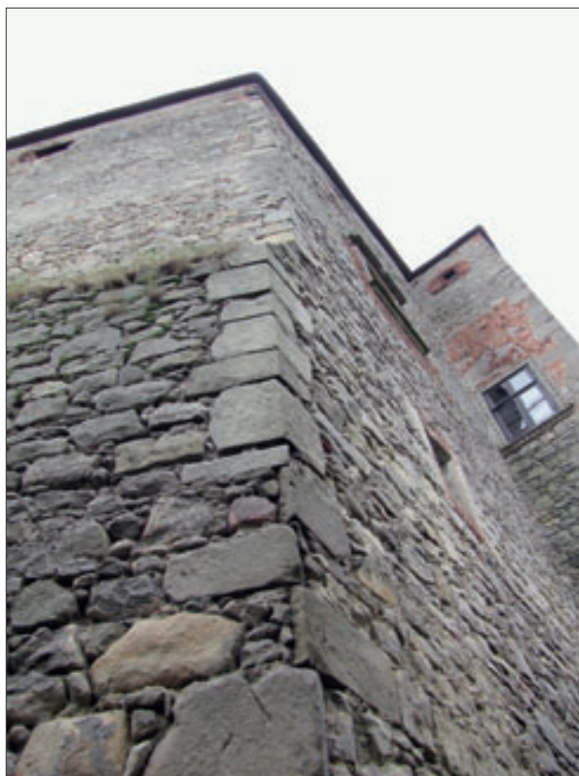
Obr. 7: Hrad Buchlov, detail severovýchodního nároží severního traktu; v armatuře jsou druhotně použity starší, architektonické prvky.
