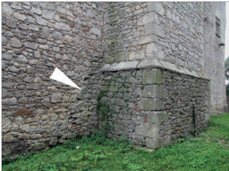
Obr. 10: Hrad Buchlov, detail spodní partie zdiva vnějšího průčelí, východně od hranolového rizalitu. Napravo trnož hranolového rizalitu (nad římsou se ve zdivu nacházejí druhotně použité architektonické detaily, srov. obr. 12), bílá šipka vlevo ukazuje na torzo staršího, půdorysně předstupujícího zdiva.
