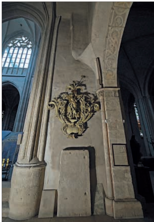
Obr. 11: Kolín, kostel sv. Bartoloměje. Zbytek jižní stěny zrušeného severního bočního chóru. Po levé straně pilíř parléřovského chóru, při vítězném oblouku (vpravo) raně gotická klenební přípora (foto J. Beránek, 2012).
