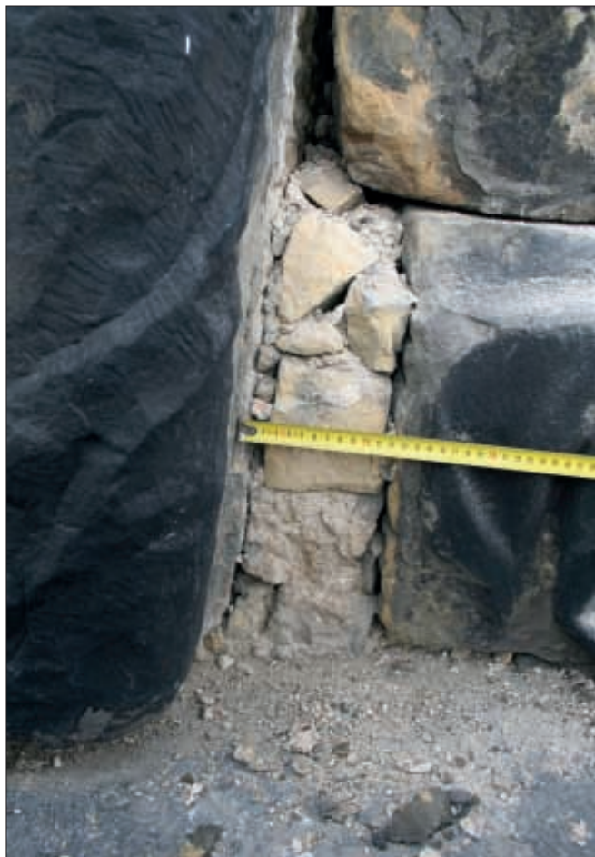
Obr. 10: Praha, Karlův most, sousoší sv. Vincence Ferrerského a sv. Prokopa, původní detail zazdívký příliš široké spáry mezi postavami Posedlého ďáblem a sv. Prokopem na zadní straně (foto J. Kačer, 2012).
