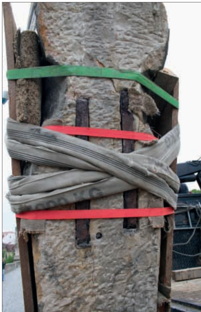
Obr. 13: Praha, Karlův most, sousoší sv. Vincence Ferrerského a sv. Prokopa, pohled na zadní stranu hermovky s polopostavou Ďábla, detail zajištění trhlíny a charakter opracování tohoto dílu na zadní straně (foto J. Kačer, 2012).
