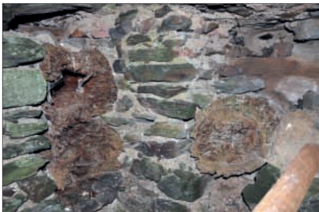
Obr. 21: Pozůstatky dřevěného roštu nad 2. patrem věže, detailní pohled do jihovýchodního kouta (snímek autor, 2011).
