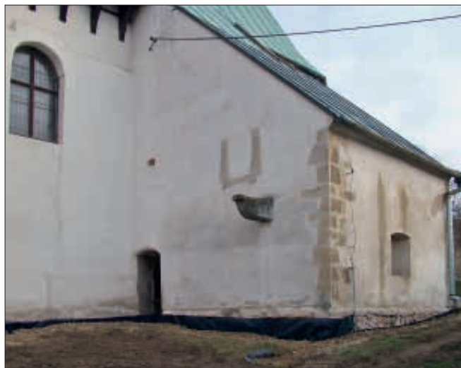
Obr. 17: Kurdějov, kostel sv. Jana Křtitele. Pohled od jihozápadu na ubouranou jižní věž se sakristií v přízemí.
