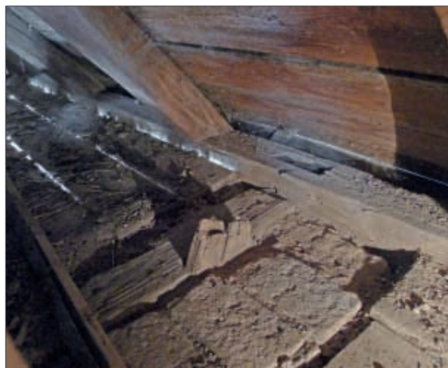
Obr. 31: Kurdějov, kostel sv. Jana Křtitele. Krov lodi, podélný práh s dlabem pro nosný sloupek polopatrá a starý vazný trám s odříznutou záporou sloupku.
