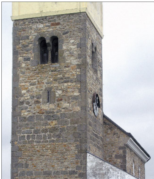
Obr. 10: Obděnice, kostel Nanebevzetí P. Marie. Detail věže od jihozápadu, dobře jsou patrné změny struktury líce zdi (není-li uvedeno jinak, foto J. Veselý, 2013).
