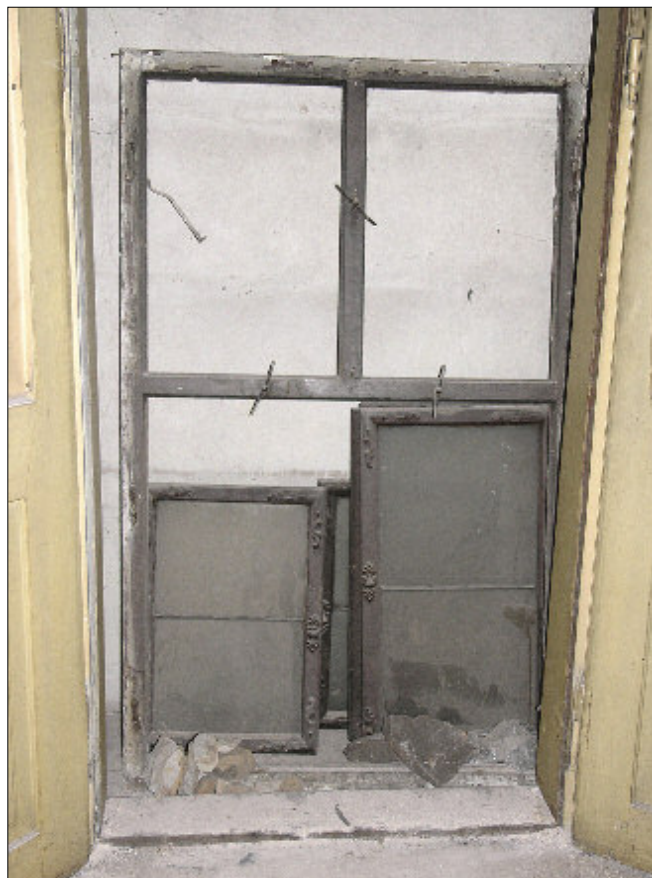
Obr. 19: Brandýs nad Labem, dům čp. 98 – okenní výplň volně uložená v objektu, pravděpodobně z přestavby kolem roku 1775, stav 2005.
