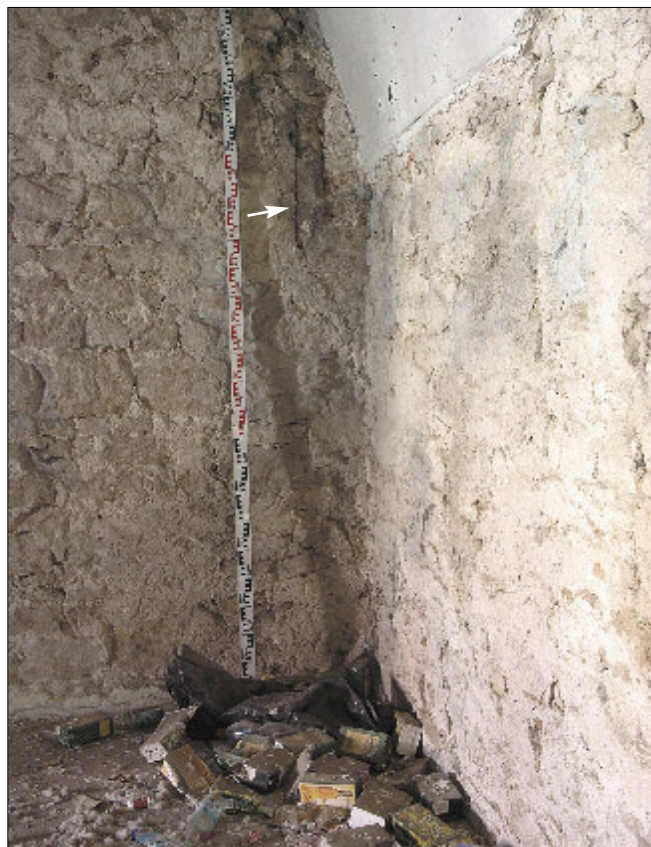
Obr. 15: Brandýs nad Labem, dům čp. 98 – přízemí, střední místnost. Část pozdně gotického ostění s okosenou hranou zachovaná v parcelní stěně s čp. 97, stav 2013.
