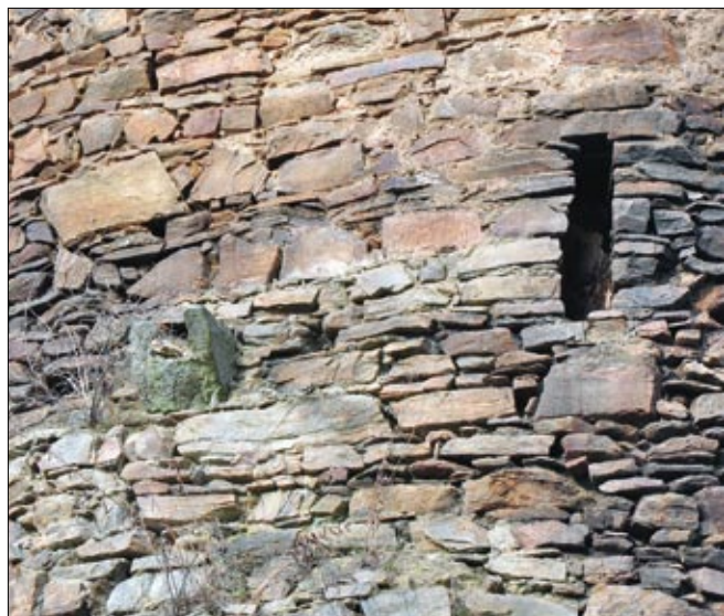
Obr. 33: Hasištejn, detail vnějšího pláště východní parkánové bašty (srov. obr. 30 a 32) s jednou ze střelnic v přízemí a zbytky vystupujícího, ulomeného koryta (2014).
