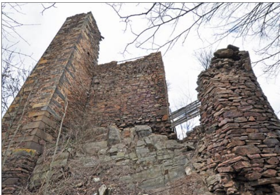
Obr. 13: Hasištejn, pohled na věžový palác od jihu. Vlevo dodatečný opěrný pilíř, vpravo zaoblené nároží hradby (2014).
