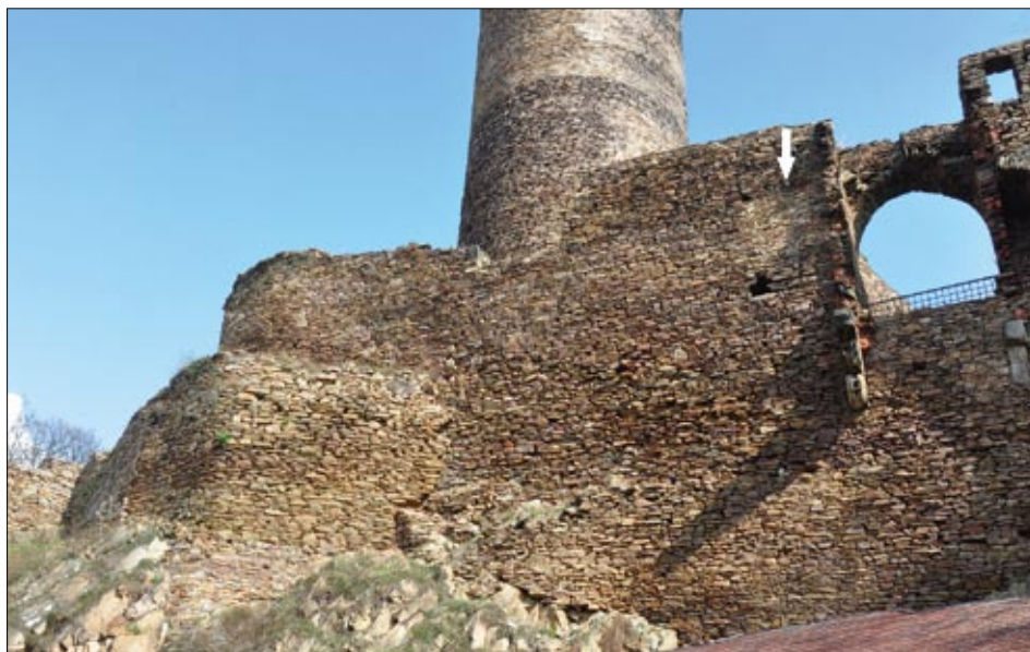
Obr. 9: Hasištejn, pohled z tzv. dolního hradu na západní část hradby jádra s velkým otvorem po zaniklém pozdně gotickém arkýři (vpravo). Vlevo k hradbě na spáru přiléhá parkánová zeď. Šipkou označeno místo zrušeného prevétu (srov. obr. 8; 2014).
