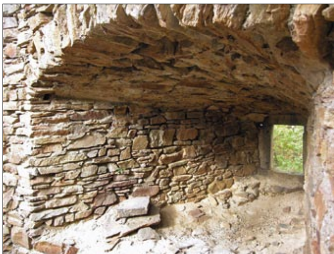
Obr. 50: Hasištejn, věž předsunutého opevnění, detail jedné z palebných komor 2. patra, s poškozenou parapetní plochou. V patě záklenku drobné otvory po dřevěných kuličkách, na nichž bylo založeno bednění (2006).
