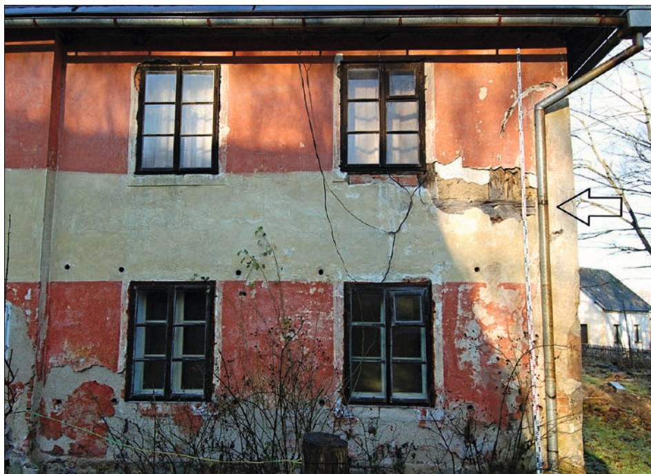
Obr. 6: Dětrichovec, mlýn čp. 30, jihovýchodní (hlavní vstupní) průčelí – pravá část; šipkou označena odkrytá hrázďená konstrukce patra (všechny snímky P. Freiwilg, 2013, není-li uvedeno jinak).
