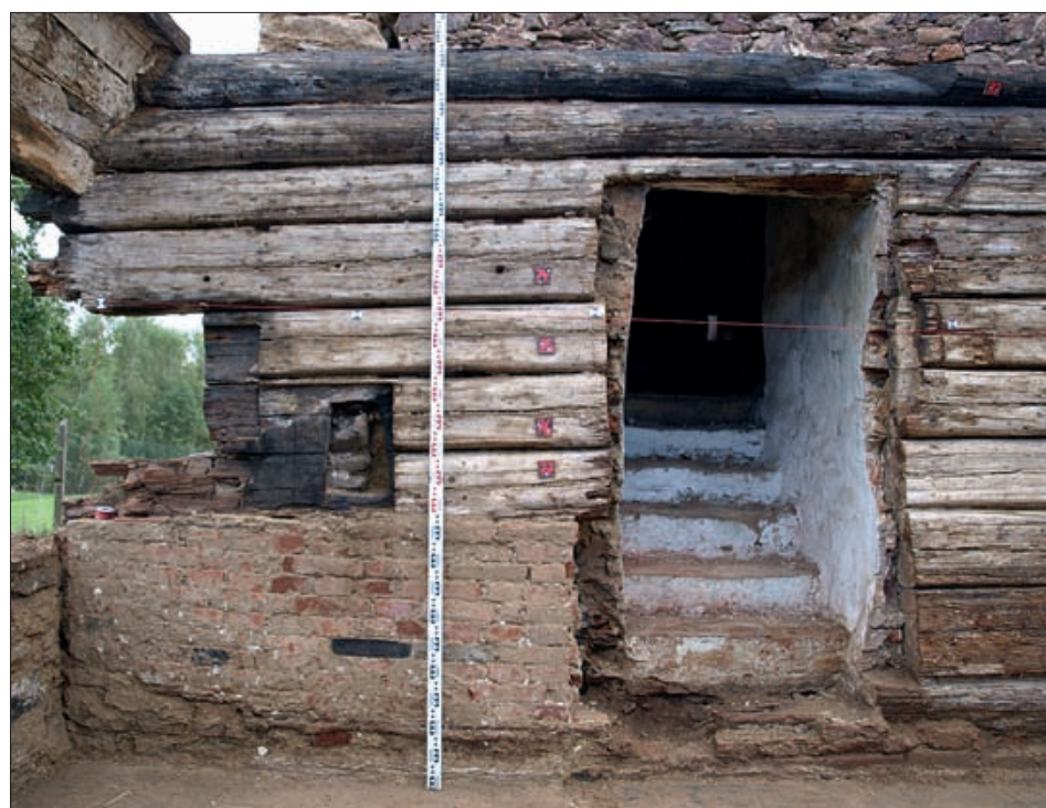
Obr. 6: Mirkovice, dům čp. 1, část východní štítové stěny při severovýchodním nároží, vlevo jsou čitelné dvě fáze okének v roubení, v textu 3. a 4. okénko. U pravé špalety vstupu do špýcharu je fragment lůžka okenice prostředního okénka jizby, nad ním dobře čitelná spodní část dymného otvoru (foto M. Princ).
