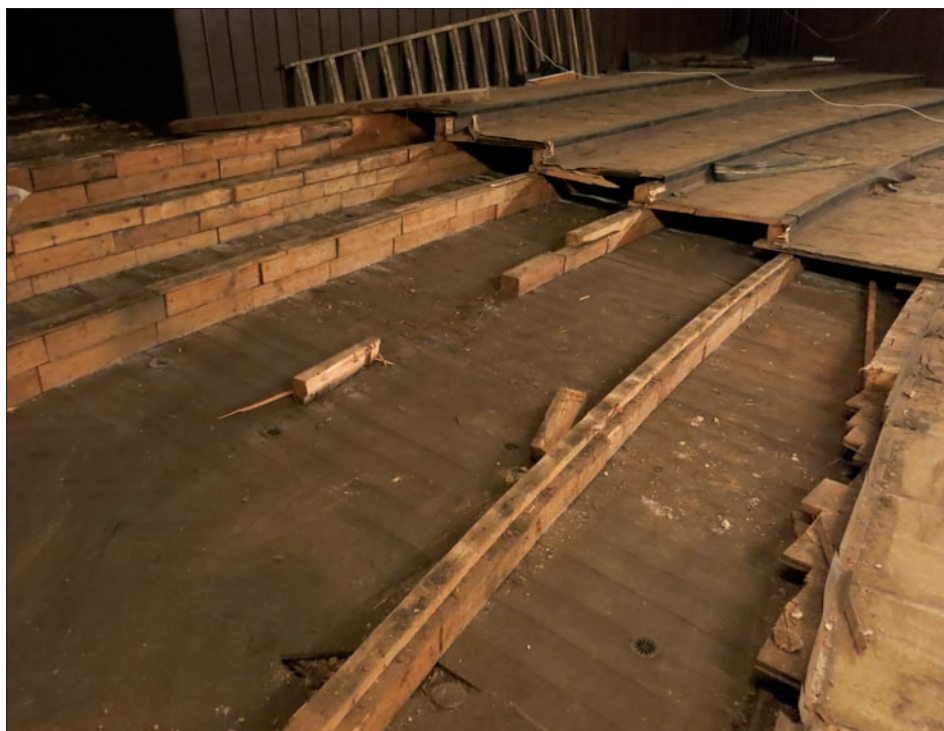
Obr. 26: Liberec, kino Varšava – původní stupňovité podlahové souvrství s větracími otvory, v současnosti ovšem určené k odstranění díky rozsáhlému napadení dřevomorkou (foto A. Řičáňková, prosinec 2013).
