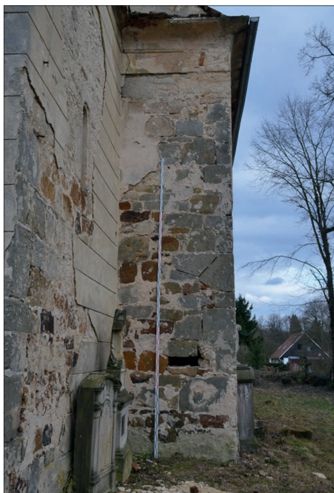
Obr. 5: Drchlava, kostel – pohled na jihozápadní nároží lodi s výrazným armováním, vlevo dutina po vyhnulé výztuze v síle zdiva a navazující předstupující shodné románské zdivo věže.
