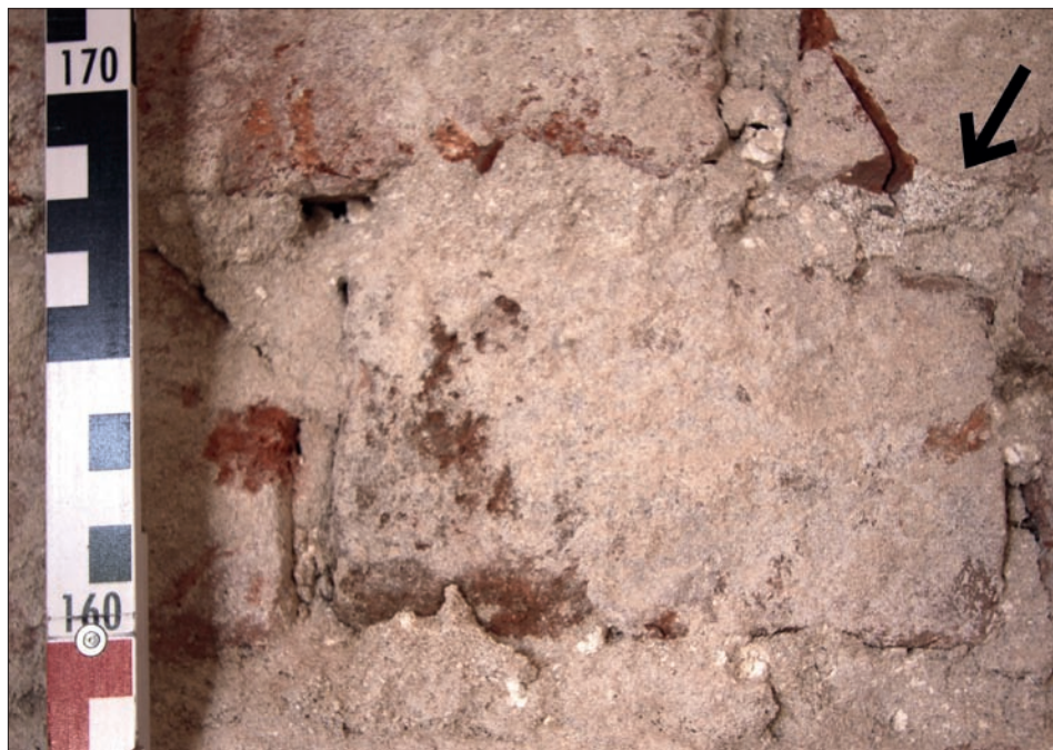
Obr. 15: Kladruba nad Labem, (okres Pardubice), zámek čp. 1, zeď 1.01a při rozhraní druhé perštejské a pozdně renesanční fáze, detail. Pernštejská malta zanesená s druhotně použitou cihlou do spáry pozdně renesančního zdiva (foto...).
