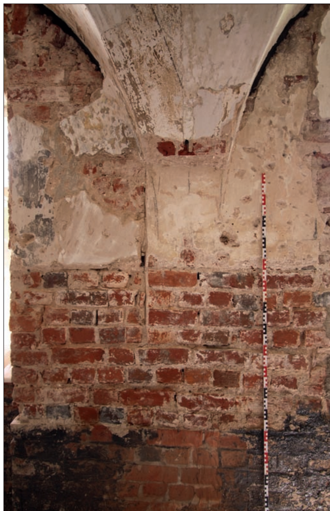
Obr. 14: Kladruba nad Labem, (okres Pardubice), zámek čp. 1, detail pohledu 1.07a. Odsekaná pata pozdně renesanční klenby se situací zazdivky otvoru z druhé perštejské fáze. Na omítkách druhé renesanční fáze patrné nárysy přestavby budovy (foto...).
