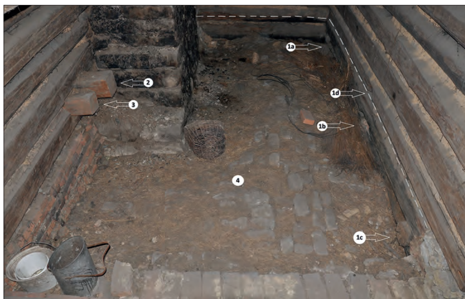
Obr. 26: Frýdštejn, usedlost čp. 21 – pohled na situaci nad černou kuchyní: 1a, 1b, 1d – stopy po konstrukci dřevohlíněného dymníku; 1c – odříznutá část trámu téže konstrukce; 2 – zhlaví stropního trámu světnice; 3 – zhlaví mladší příložky; 4 – rub klenby mladší černé kuchyně, linie vymezuje úroveň zadýmení trámů stěn (foto M. Ouhrabka, červenec 2015).
