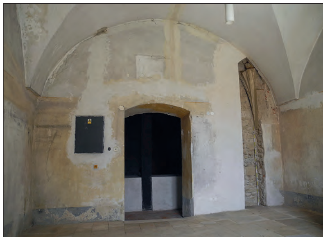
Obr. 4: Bělá pod Bezdězem, klášter – pohled na stěnu mezi sakristií a černou kaplí s nálezem výběhu žeber klenby (všechny snímky E. Vyletová, 2015).
