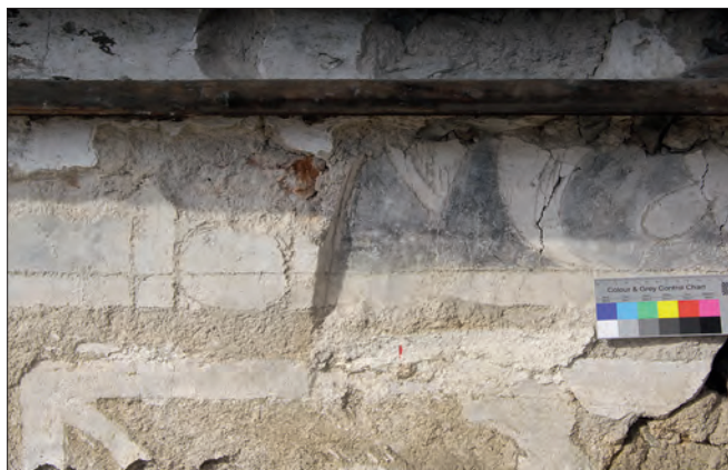
Obr. 5: Orlice, zámek – jižní fasáda, fragment lunetové římsy, detail. Vlevo náběh klenby římsy s hranou lemovanou zjednodušeným vejčovcem, upravo tmavší plocha lunety. Dole okraj nadokenní římsy, barevná úprava málo patrná (foto E. Racková, 2011).
