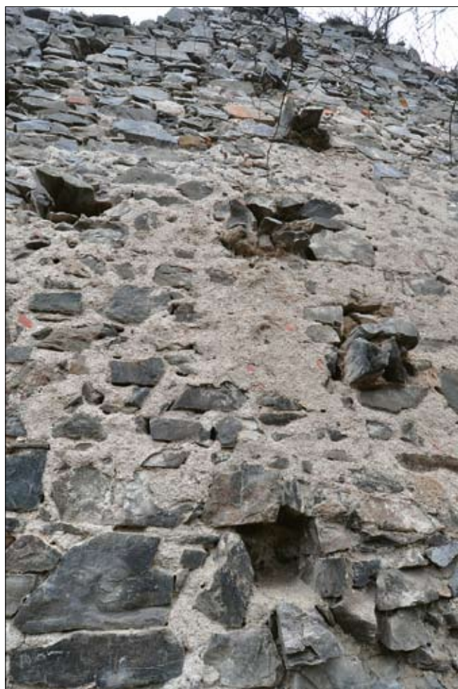
Obr. 6: Detail (srov. obr. 5) části kotev zaniklé přízdívky (2016).
