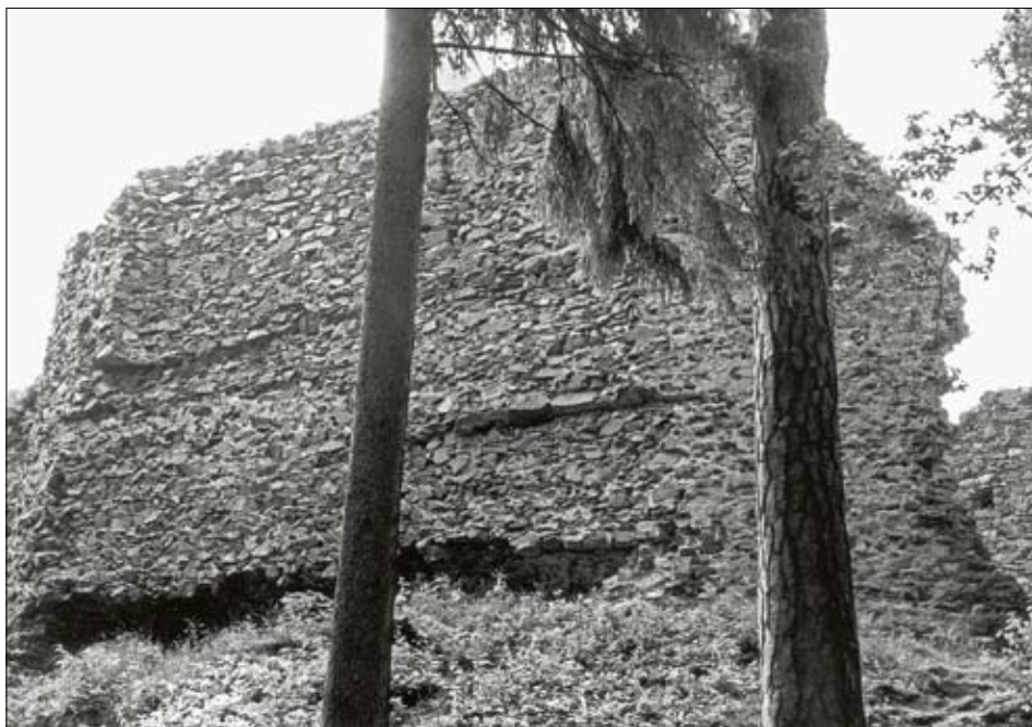
Obr. 13: Budova druhotně vložená do oblouku hradby jádra, pohled od severozápadu. Nelícovaná severní obvodová zeď, obnažená v důsledku zboření hradby. Dole pásový podkop zdi, jejíž destrukce se nezdařila (1999).
