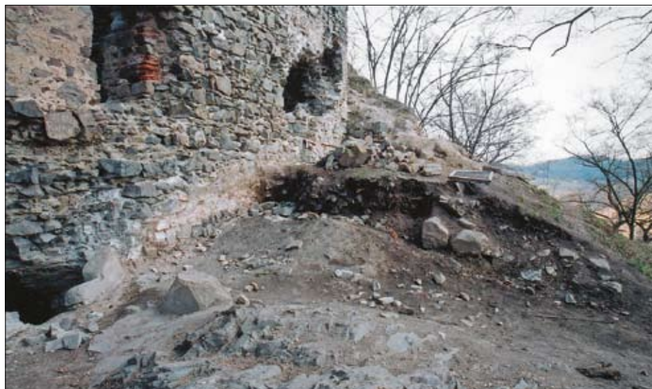
Obr. 26: Budova druhotně vložená do oblouku hradby jádra, detail jižního průčelí v době nezákonného výkopu. Vlevo okénko do západní části sklepa (srov. obr. 19), výše okna přízemí (2002).
