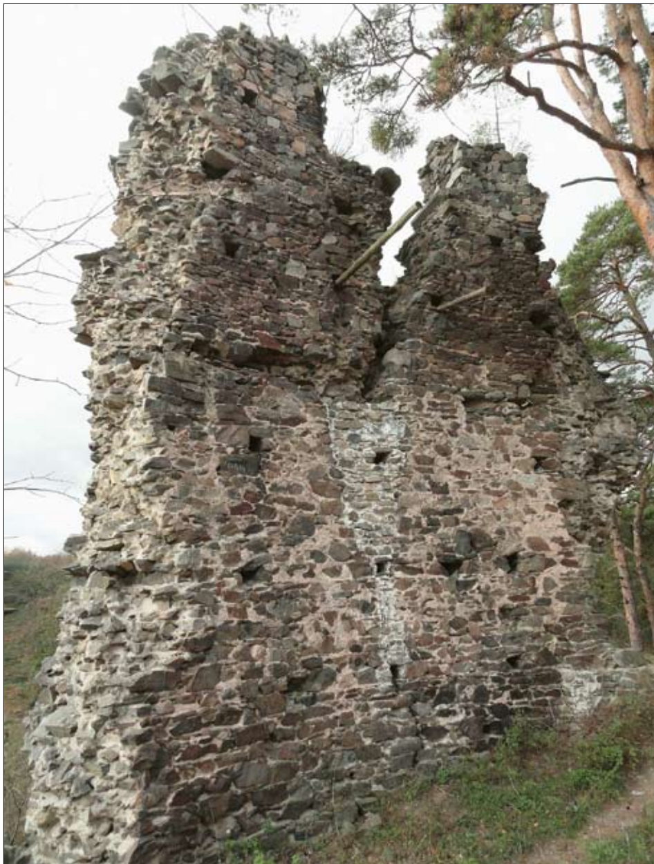
Obr. 28: Západní palác jádra hradu, vnitřní líc fragmentu zdi s opěráky. Uprostřed amatérsky částečně zacelená trhlinka, nad horním koncem trhlinky nika okna s postranními tesanými sedátky (2015).
