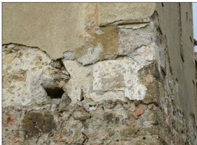
Obr. 5: Popice u Znojma – kostel sv. Zikmunda. Odkryté diamantování na nároží věže (foto L. Šabatová, 2005).
