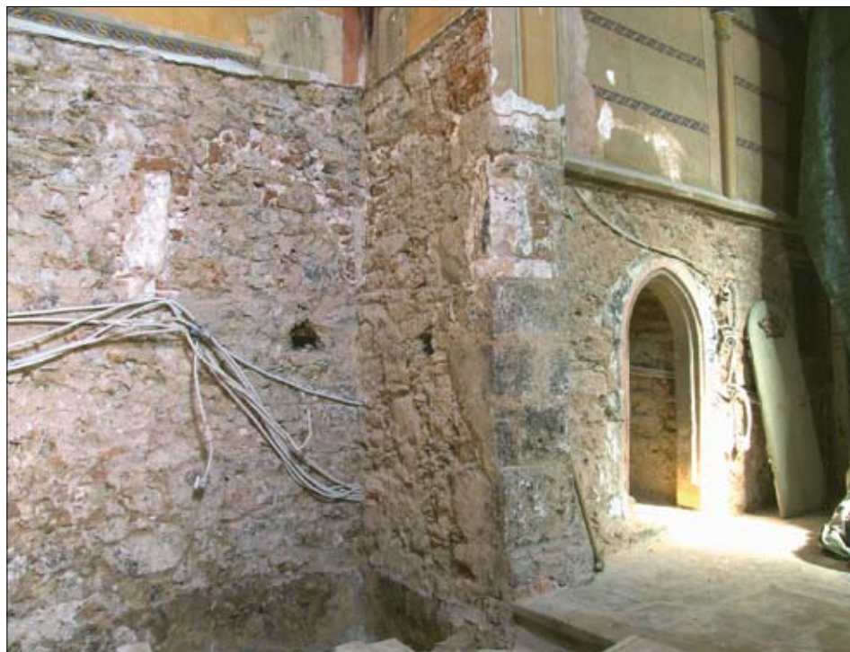
Obr. 9: Popice u Znojma – kostel sv. Zikmunda. Pohled směrem do východní části kostela. V koutě lodi situace po odstranění zděné klenuté konstrukce, totožná s jižním koutem lodi, v pozadí portálek do sakristie (foto P. Dohnalová, 2012).
