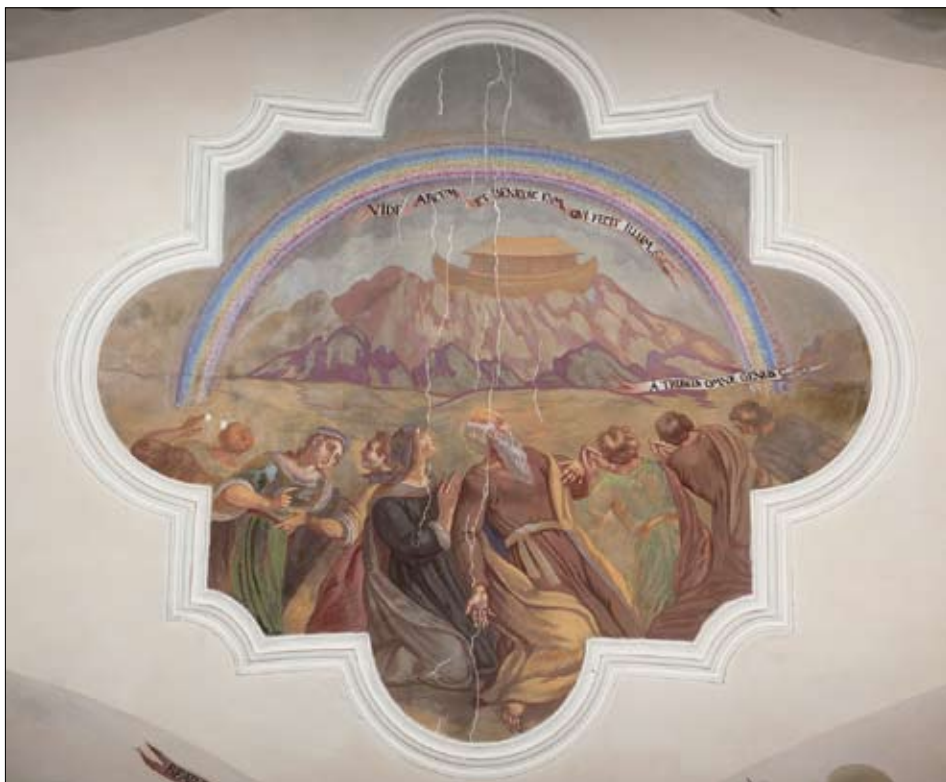
Obr. 21: Kostel Nejsvětější Trojice na Křemešníku. Oběť Noemova, klenba hlavní lodi. Stav před restaurováním.
