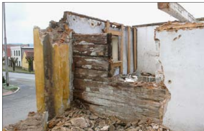
Obr. 20: Merklín – usedlost čp. 19. Obytné stavení, zápražní (severovýchodní) strana, část blíže jihovýchodnímu nároží. Odhalená roubená stěna v místech okna, které osvětlovalo světnici v průčelí. Stav v průběhu demolicie objektu v roce 2014.
