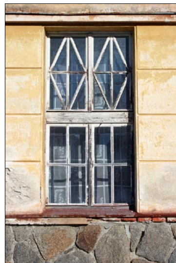
Obr. 23: Kovčín – detail okenní výplně v přízemí budovy školy čp. 57, stav 2013.
