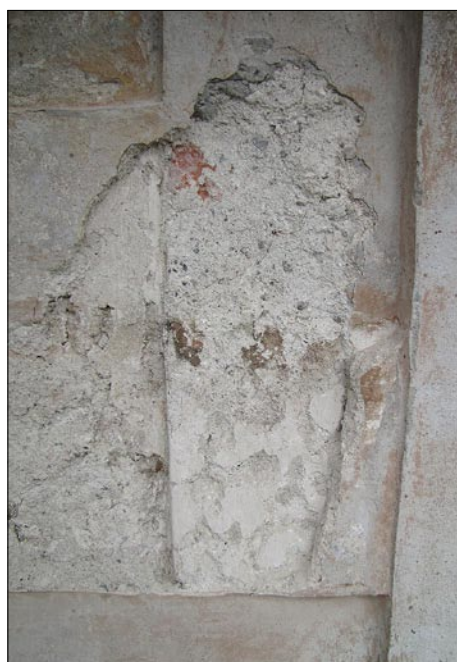
Obr. 12: Holešov, zámek, typická nálezová situace styku lizénového rámce fasády (vpravo) s dodatečně přiloženým, horizontálním omítkovým pásem mezi prvním a druhým patrem (vlevo).
