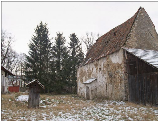
Obr. 4: Radošovice, sýpka usedlosti čp. 9 – stav těsně před destrukcí krovu (foto J. Havlice, 2008)
