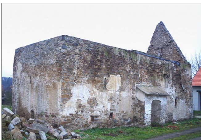
Obr. 8: Radošovice, sýpka usedlosti čp. 9 – stav po destrukci jižního štítu a následné částečné opravě obvodového zdiva (foto D. Šnejd, 2015).
