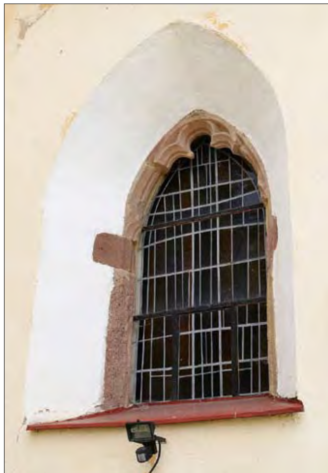
Obr. 38: Kondrac, kostel sv. Bartoloměje, původně sv. Mikuláše – východní okno sakristie s torzem kružby.
