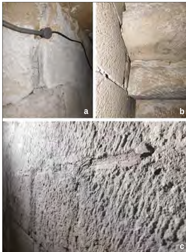
Obr. 14: Hulín, kostel sv. Václava, konstrukční detaily chodbičky v tloušťce severní zdi lodi: a – ledabylo opravená porucha kvádrových řad na severní stěně chodbičky; b – kontrast kvalitně opracovaných bloků severní stěny chodbičky a hrubě osekávaných bloků zastropení schodiště; c – detail opravy jednoho z kamenných kvádrů a původní úpravy spáry s maltovou výplní a podřezáváním.
