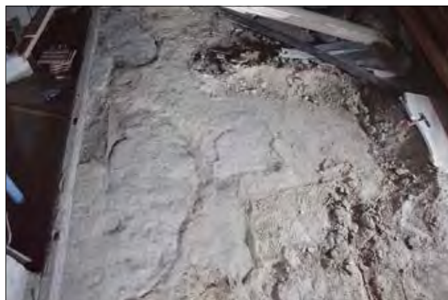
Obr. 15: Vyšší Brod, dům čp. 24, pohled na rubovou část stropu světnice s vyspravovaným lepenecem, vlevo vedle komína je poslední trám roubení s dlaby pro nosné prvky dymníku (?), kruhový otvor je zakrytý vrstvou lepence (foto J. Bloch).
