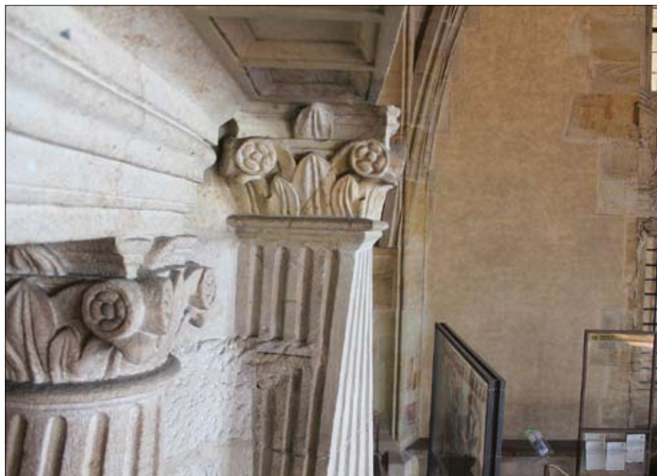
Obr. 19: Pražský hrad, Vladislavský sál, portál do Sněmovny, detail vnitřní strany pilastru pravé strany portálu s patrným odsekáním římsy zaniklého krbu.
