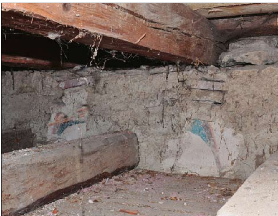
Obr. 12: Křištín, kostel sv. Matouše, jižní strana půdního prostoru lodi mezi stropy, fragment nástěnné malby andělů patrně ve scéně Posledního soudu, kolem roku 1500.
