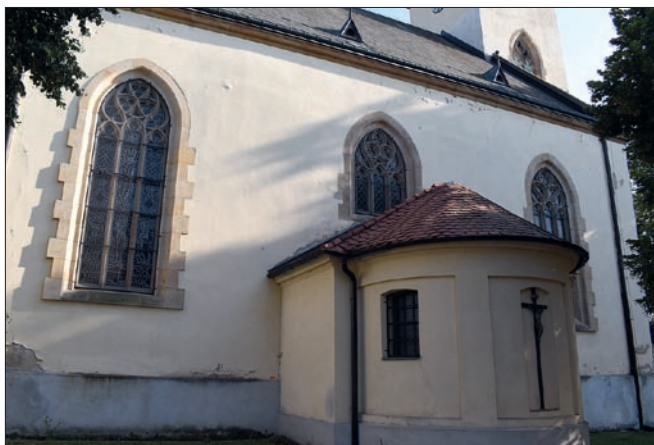
Obr. 45: Poděbrady, kostel Povýšení sv. Kříže. Severní fasáda trojlodí s kaplí sv. Cyrila a Metoděje. U novogotického ostění vlevo patrný výklon obvodové zdi (ostění je svislé) (stav 2024).
