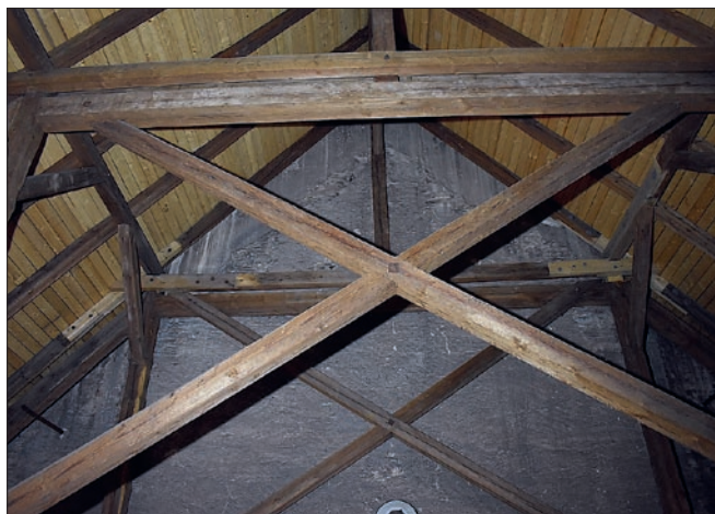
Obr. 47: Poděbrady, kostel Povýšení sv. Kříže. Otisk barokní střechy na východní straně věže (stav 2024).
